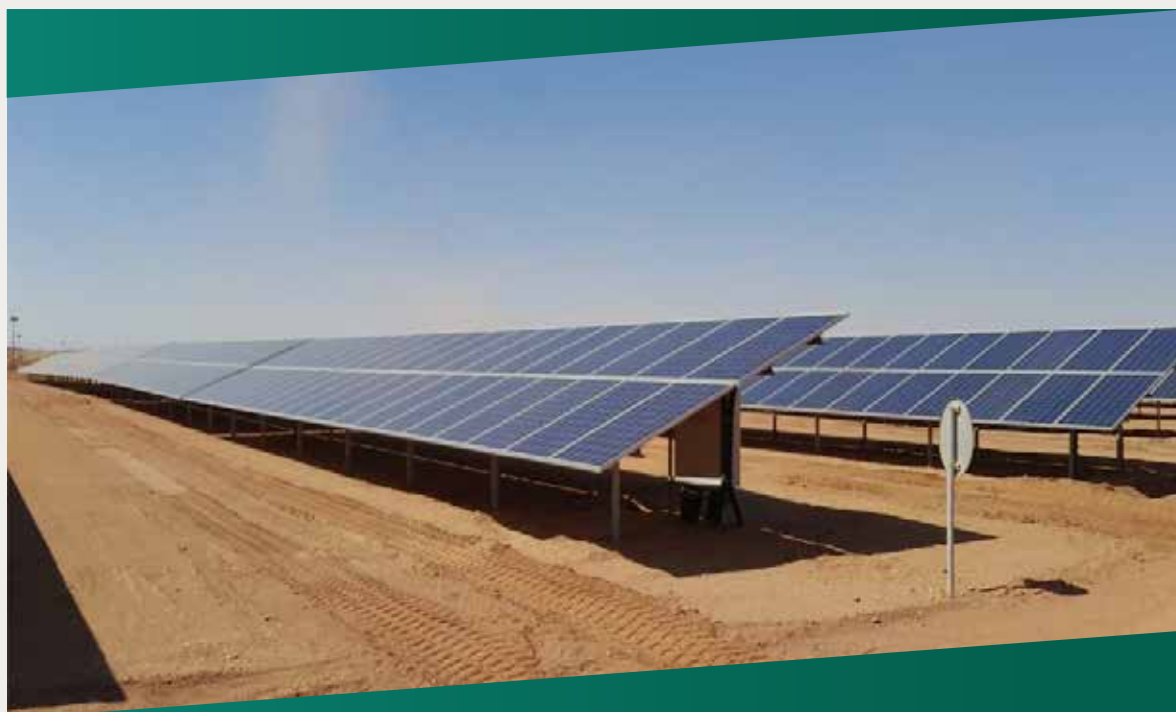
مشروع محطة كوم امبو قدرة ٢٦ ميجاوات
